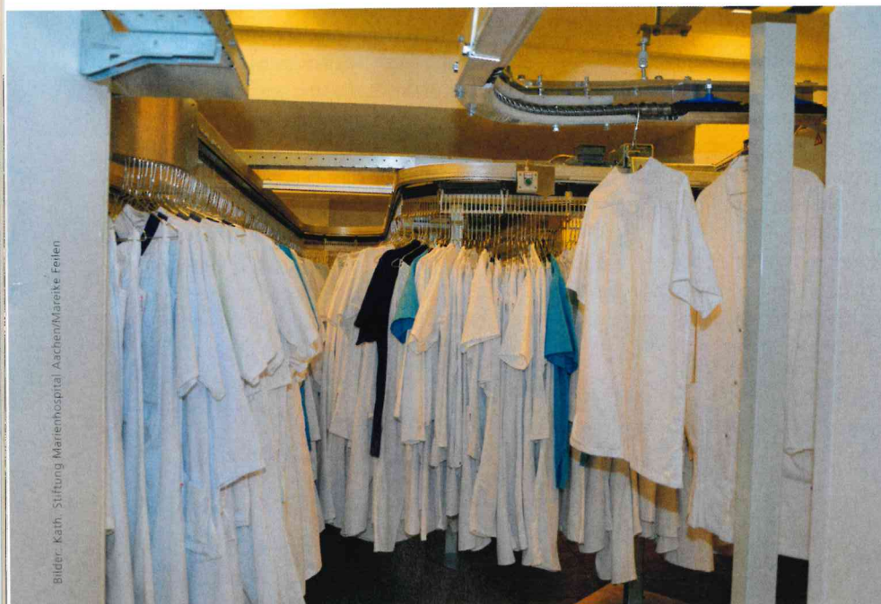
Blick ins Innere: Dank des neuen Wäscheautomaten im Marienhospital Aachen erhalten die Mitarbeiter jeden Tag frische Dienstbekleidung auf Knopfdruck.
